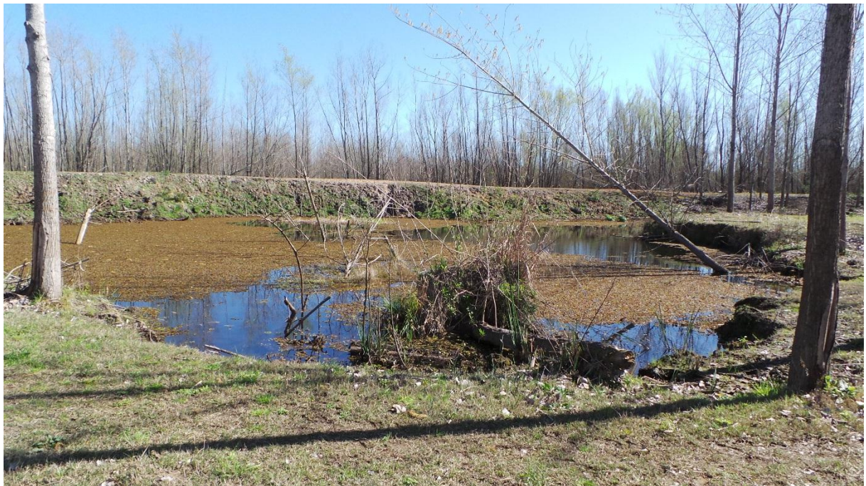
Figura 2.15. Fosa generada por el agua que ingresó al colapsar el dique durante crecida de 2016.
